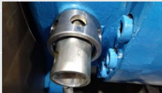
Czujnik typu WS-1VT wraz z osłoną zamocowany do przekładni i silnika napędu przenośnika ścianowego
